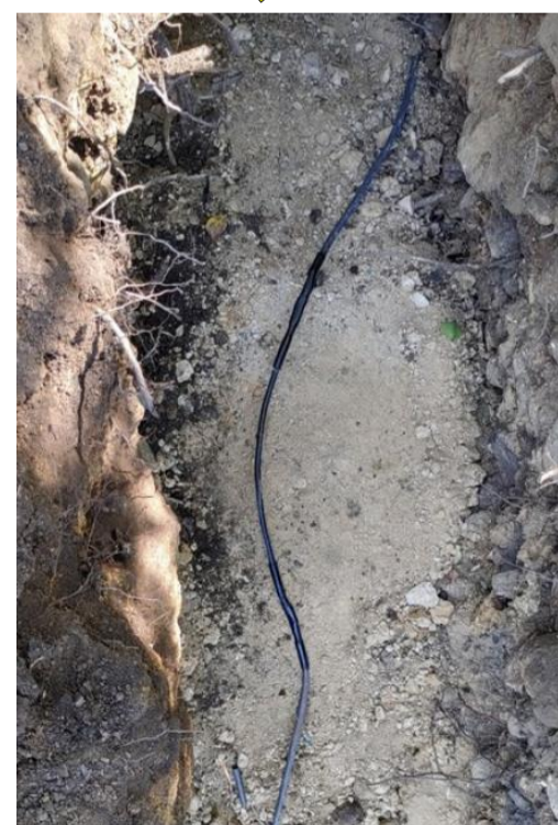
PŘEKOPNUTÝ A OPRAVENÝ KABEL K VODOMĚRU
