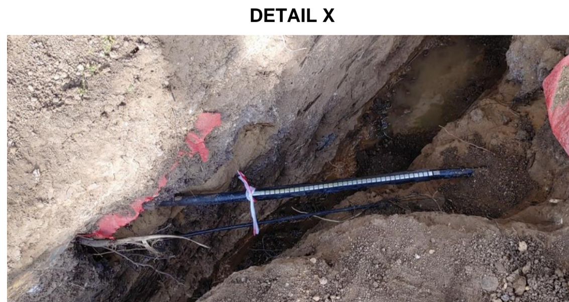
OPRAVENÝ KABEL K PYTLOUNOVI BAGREM DOŠLO POUZE K DROBNÉMU POŠKOZENÍ IZOLACE ZEMNÍČHO VOČE. KABEL OPRAVIL TECHNIK SEIMONTU.
