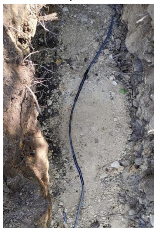
PŘEKOPNUTÝ A OPRAVENÝ KABEL K VODOMĚRU
